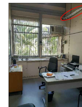
Tubulação aparente do ar condicionado, onde deverá ser colocada canaleta (conforme imagem ao lado)
